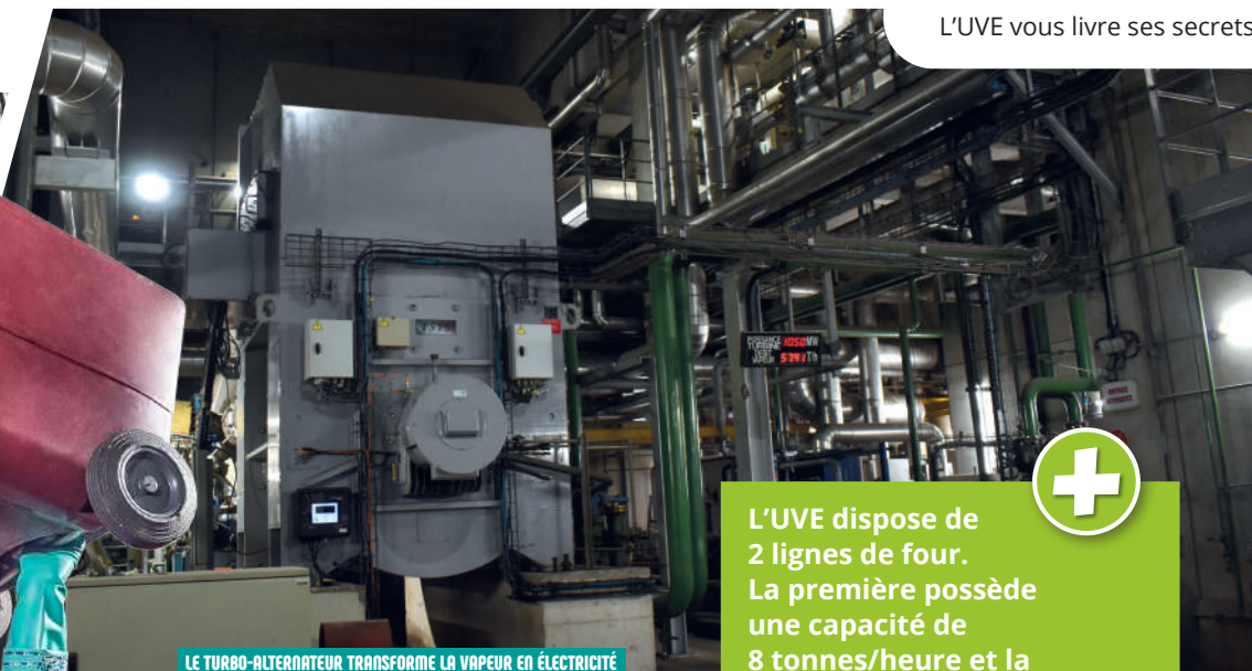
LE TURBO-ALTERNATEUR TRANSFORME LA VAPEUR EN ÉLECTRICITÉ
