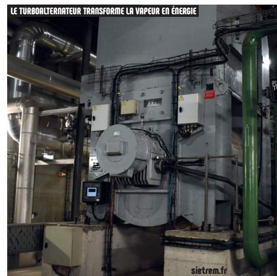
LE TURBOALTERNATEUR TRANSFORME LA VAPEUR EN ÉNERGIE
